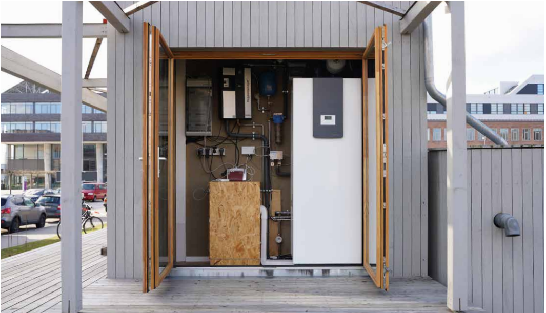
↑ Abb. 5. Das Herz der Anlage ist der eigene Technikraum, der Wasser- Strom- und Wärmeversorgung steuert. Foto: Tanja Lückner.
