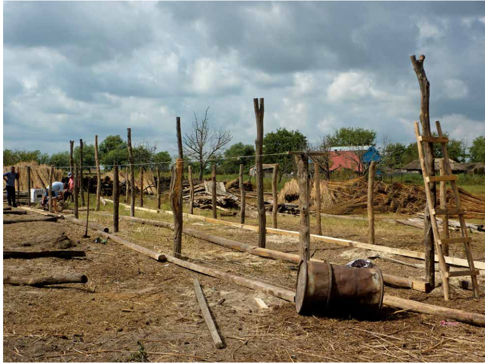
Afb. 7.26. De bouw van een schuur in Letea, Roemenië. Alle bouwmaterialen zijn verzameld en liggen klaar op de bouwlocatie.
