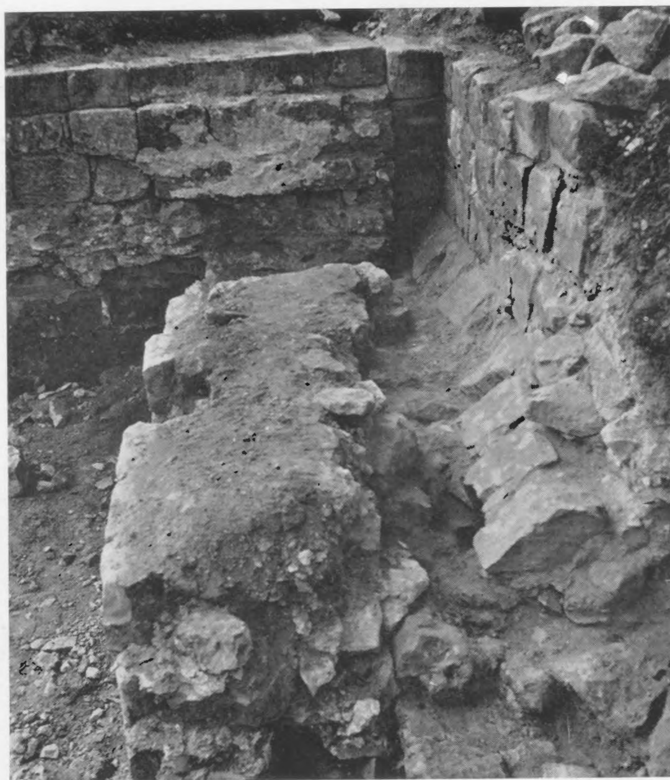
2. Le mur Ouest du magasin souterrain qui démanche sur la banquette avancée du mur Est du donjon.
